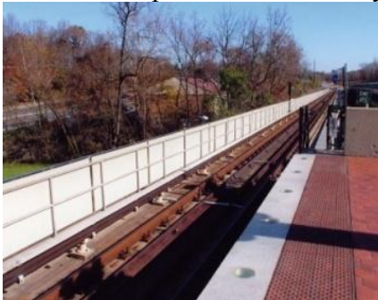
Obr. 6 Protihluková bariéra mostná konštrukcia so zvukopohltivou vložkou STERED
